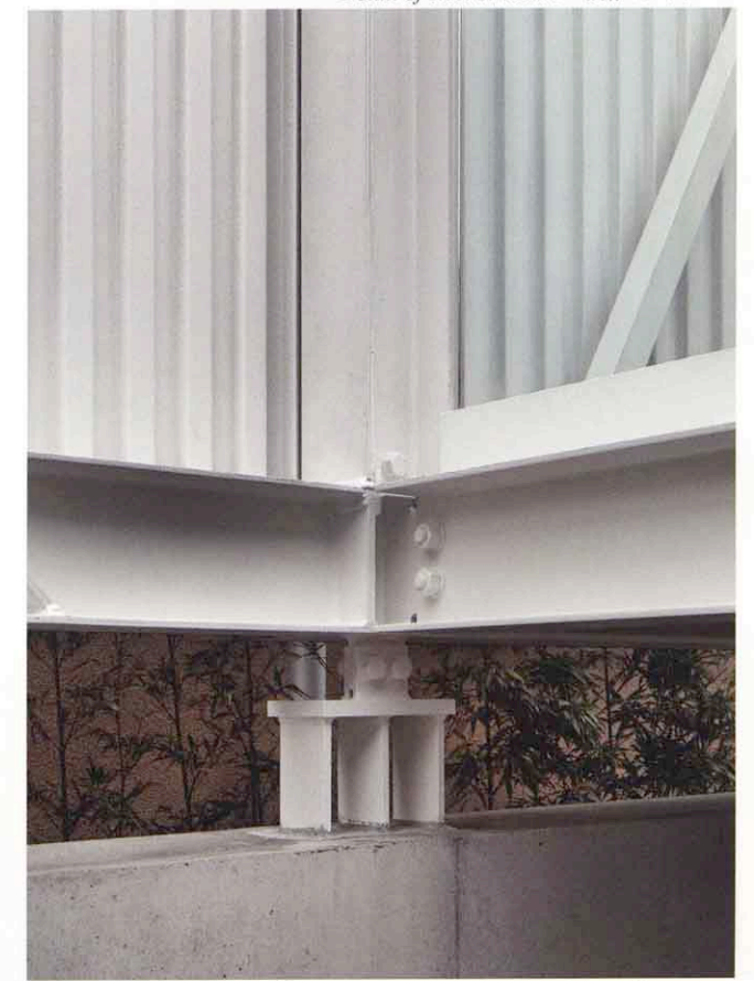
Steel structure of upper part sit on concrete volume of lower part 下部のコンクリート壁に鉄骨のストラクチャーが載る
